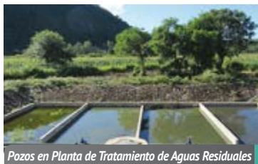
Pozos en Planta de Tratamiento de Aguas Residuales
