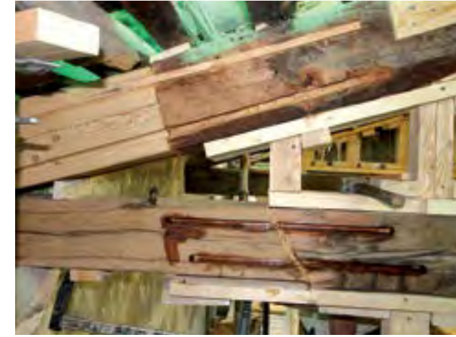
Detail der Restaurierung mit originalen und ersetzten Dachbalken Detail of restoration showing original and replacement joists Détail de la restauration avec des poutres originales et remplacées
