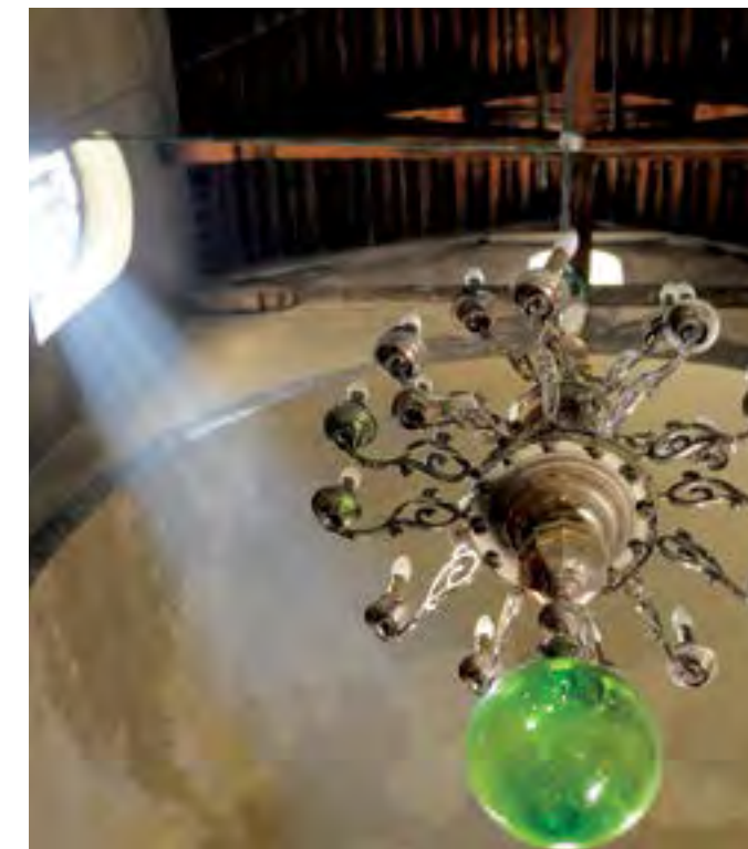
Dach und Putz vor der Restaurierung Roof and plasterwork prior to restoration Toit et revêtement avant la restauration
