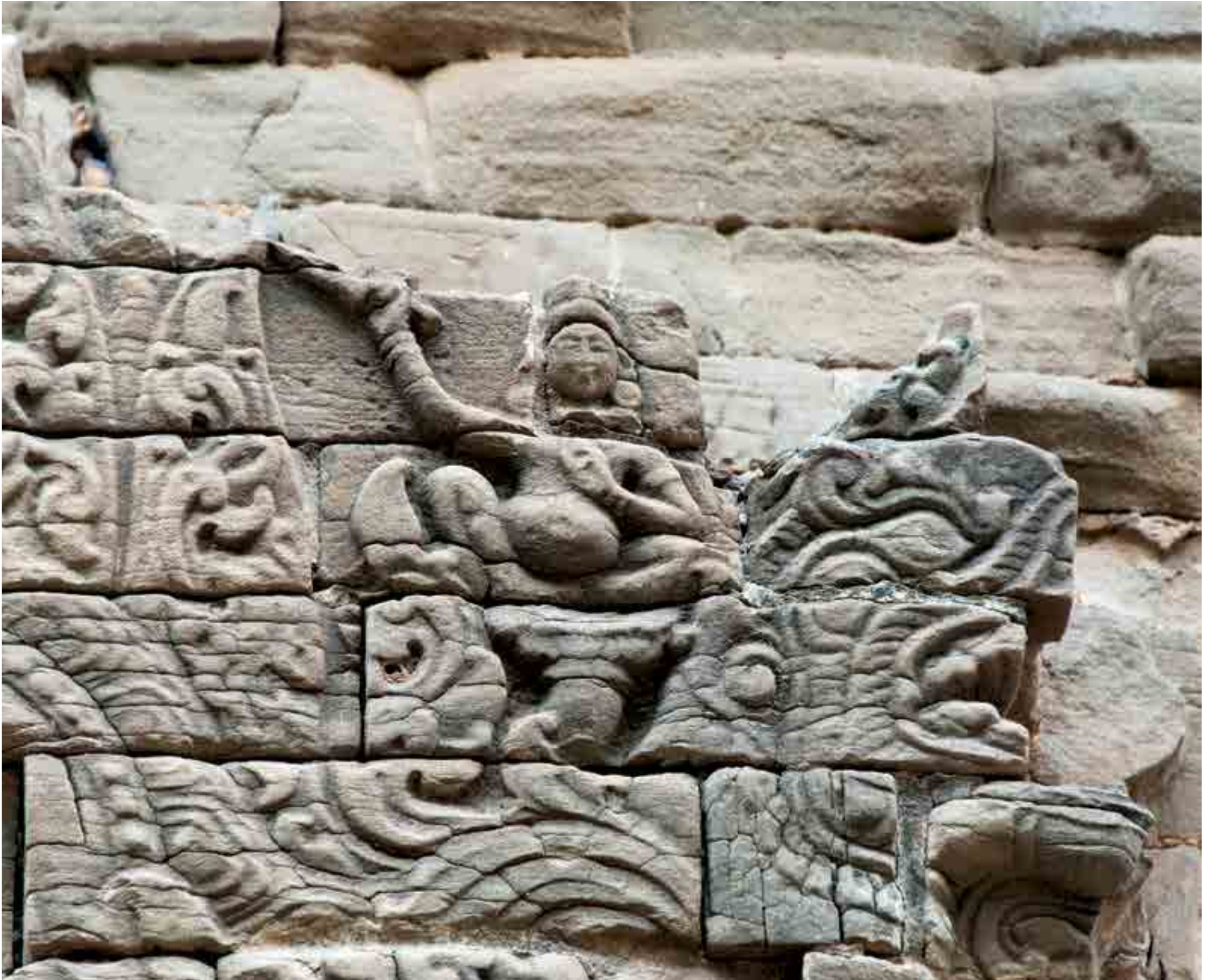
↑ Große Teile der Sandsteindekoration des Tempels sind durch den Einfluss von bauschädlichen Salzen weit zurückgewittert Gran parte de los ornamentos en arenisca del templo están fuertemente meteorizados por el influjo de sales nocivas
